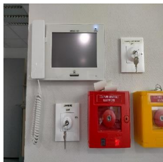
Figure 2 : boitier pour ouverture porte d'entrée visiteurs
