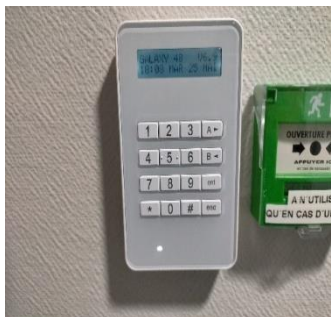
Figure 1 : alarme située à gauche de la porte d'entrée du personnel
